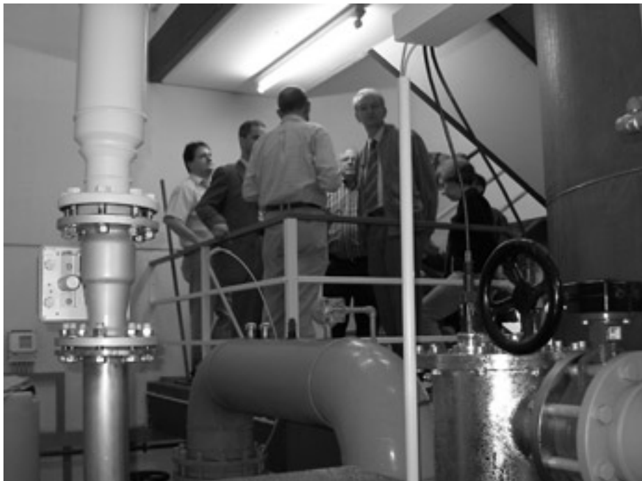
Der Hochbehälter »Gerstenland« wurde von Weisenbacher Gemeinderat besichtigt.
